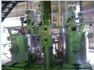
溶解設備（連続式ガス溶解炉）
