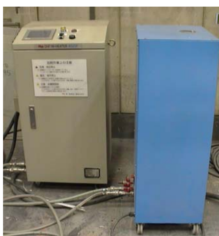
(a) 高周波加熱電源装置 (右は電源の水冷ユニット)
